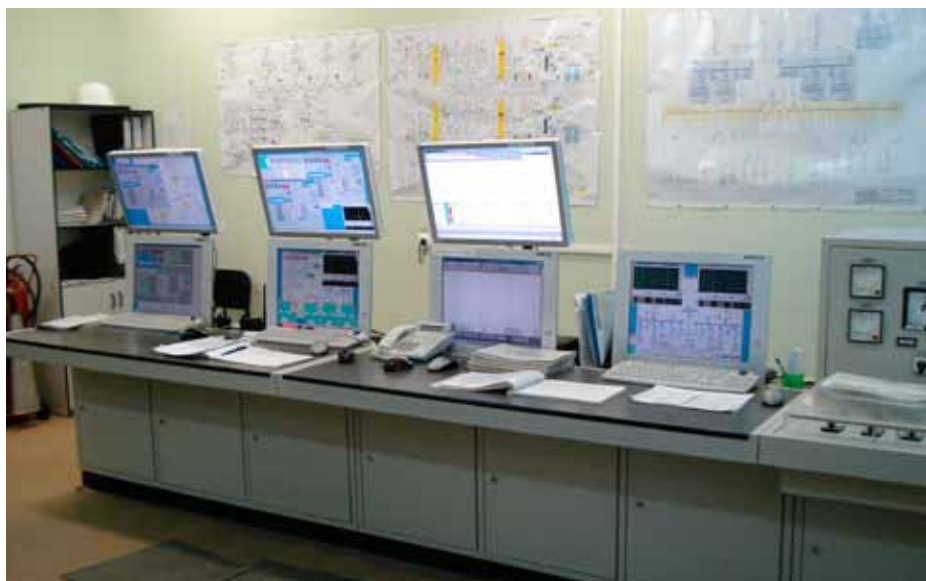
Главный щит управления ГТЭС Игольско-Талового нефтяного месторождения
